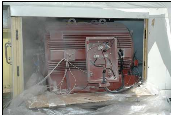
Fot. 5. Silnik 620 kW (9000 kg) w komorze badawczej
