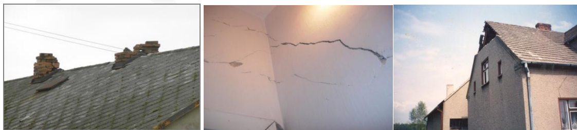
Rys. 1. Przykładowe uszkodzenia wywołane w budynkach po wystąpieniu najsilniejszych zjawisk sejsmicznych w obszarze GZW
