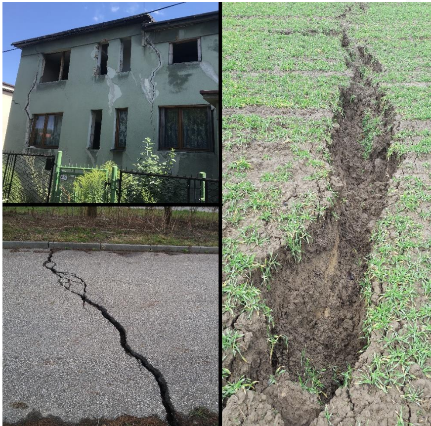
Rys. 1. Przykład deformacji powierzchni oraz zniszczeń w budynku wywołanych podziemną eksploatacją górniczą (Apanowicz 2022).
