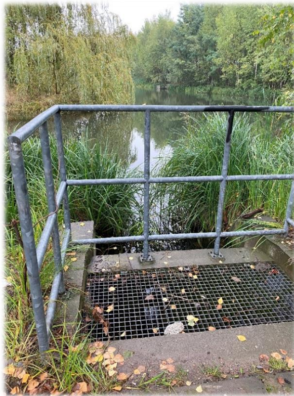
Fot. 3. Zbiornik A02-KAT-0045; widok od strony zachodniej, odbiornik wód opadowych, punkt przelewu wód do kanalizacji
