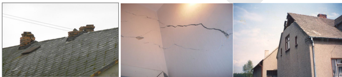
Rys. 1. Przykładowe uszkodzenia wywołane w budynkach po wystąpieniu najsilniejszych zjawisk sejsmicznych w obszarze GZW
