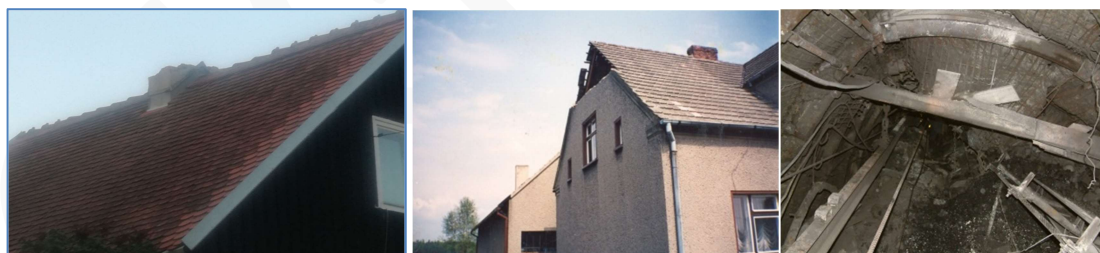
Rys. 1 Przykładowe uszkodzenia wywołane w budynkach po wystąpieniu najsilniejszych zjawisk sejsmicznych w obszarze GZW (dwa rysunki po lewej stronie: fot. G. Mutke), uszkodzenie podziemnych wyrobisk górniczych (rysunek po prawej: z materiałów po tąpnięciu KWK Śląsk z roku 2008)
