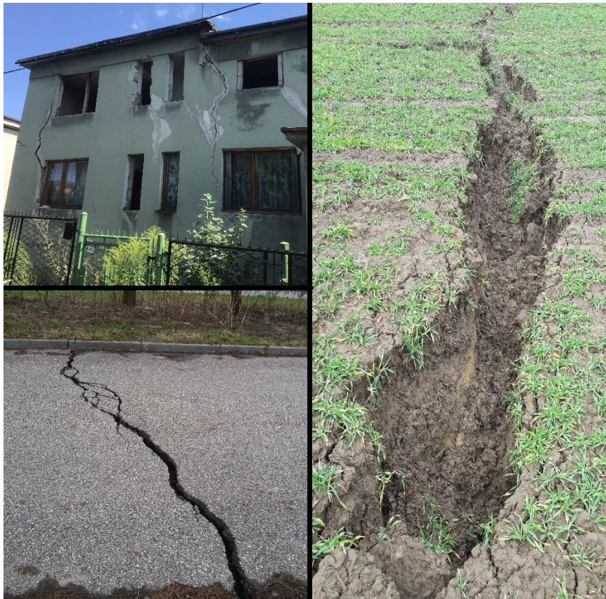
Rys. 1. Przykład deformacji powierzchni oraz zniszczeń w budynku wywołanych podziemną eksploatacją górniczą (Apanowicz 2022).
